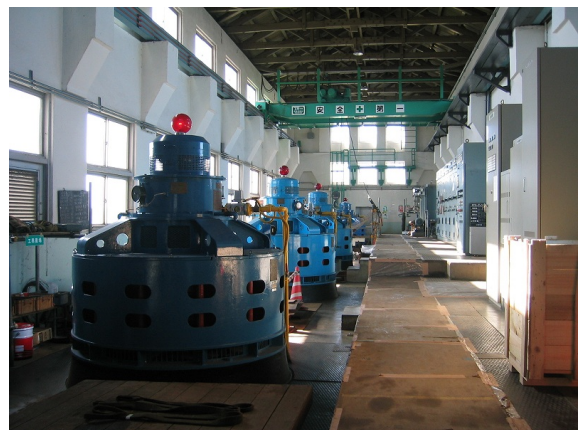
昭和27年製作の貴重な排水機がまだ稼働中
