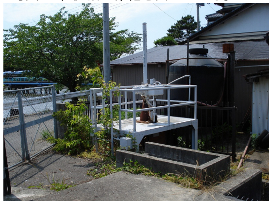
洗堀のポンプ設置場
