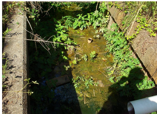
上流部は水が流れず、ドロが堆積していた
