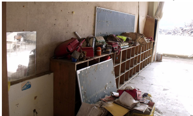
2階の教室には津波の時のランドセルが置いてあった
