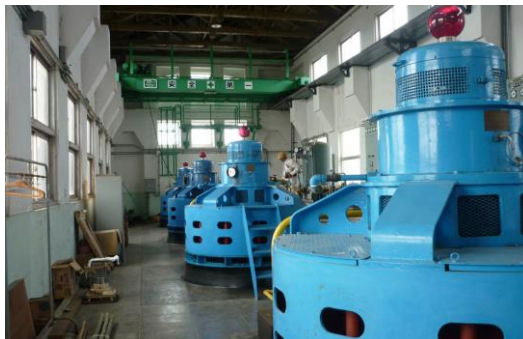
新川右岸排水機場内部の 5 基のポンプ 撮影：山岸
