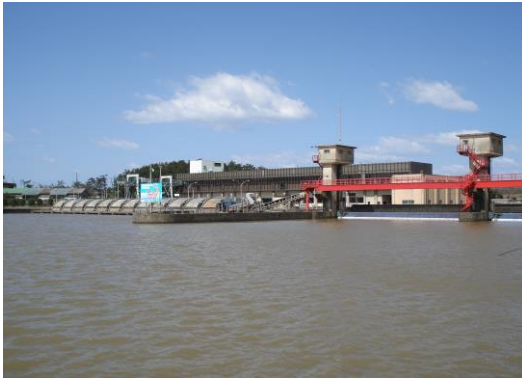
昭和 47 年完成した新川の河口排水機場 撮影：加藤
